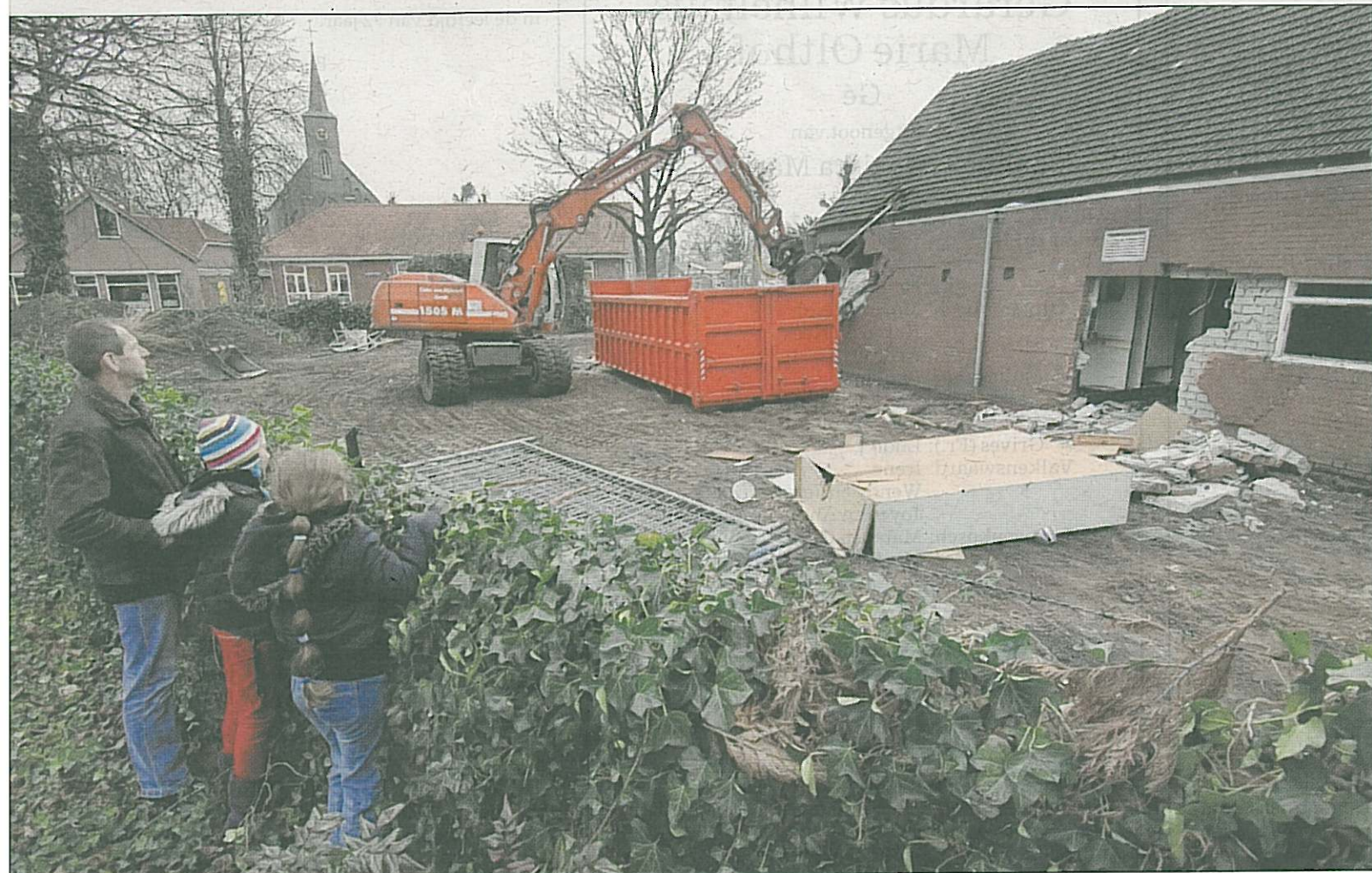
D'n Hospes in Boerdonk wordt gesloopt. In de boerderij zat al sinds 1881 een café. Toon en Annie van den Tillaart waren de laatste uitbaters. Annie was gisteren bij de start van de sloop aanwezig. Emotioneel was ze niet. „Het is tijd dat het weg gaat. Het staat al lang leeg.” foto Jeroen Appels/van Assendelft
